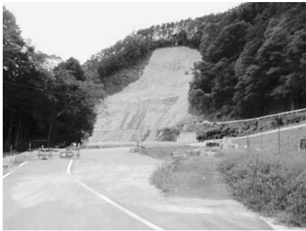
早期の復旧が待たれる崩落現場
