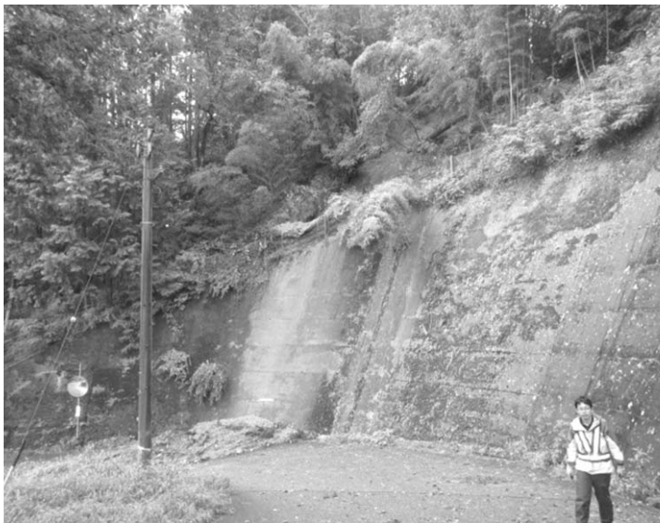
予算化された崩落現場
