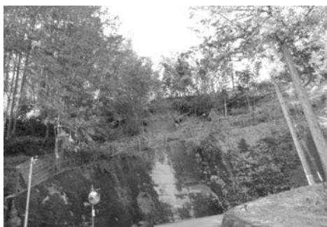
改修予定の崩落現場
