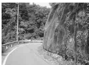
道路状況の悪い上飯田線
