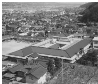
喬木荘補修を必要とする屋根部分
