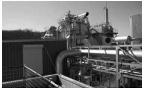
那珂川バイオマス発電所
