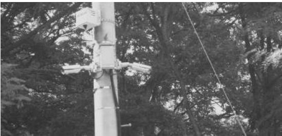
上平トンネルに設置されているカメラ
