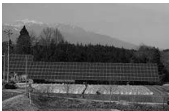
地面設置の太陽光発電設備
