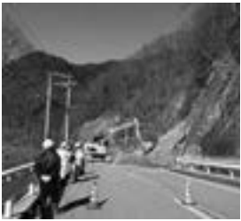
県道崩落箇所の視察
