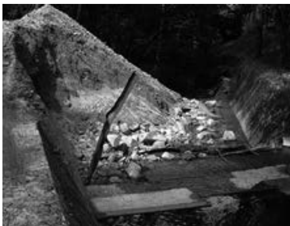
ガレキで埋まっている堰堤
