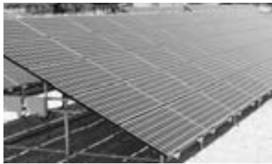
村内各地に見られる太陽光発電パネル
