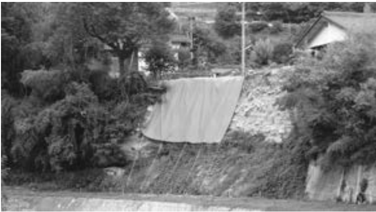
郭地区の崩落
