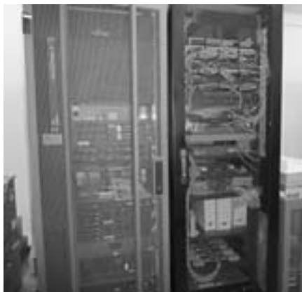
サーバー室内の一部
