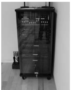
研修室用の音響設備
