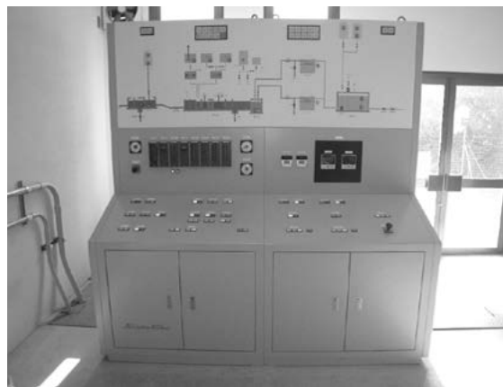
二日洞浄水場操作盤
