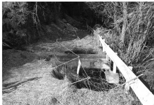
崩落の進む大島旧道
