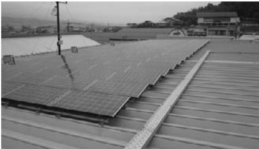
役場屋上に設置した20kwの太陽光発電パネル
