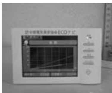
電力監視装置(ECOナビ)
